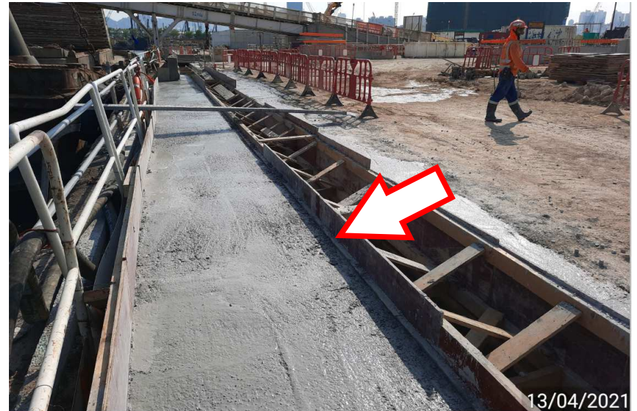
使用粒化高爐礦渣粉混凝土的臨時排水溝 Temporary Drainage Trench adopted GGBS Concrete
