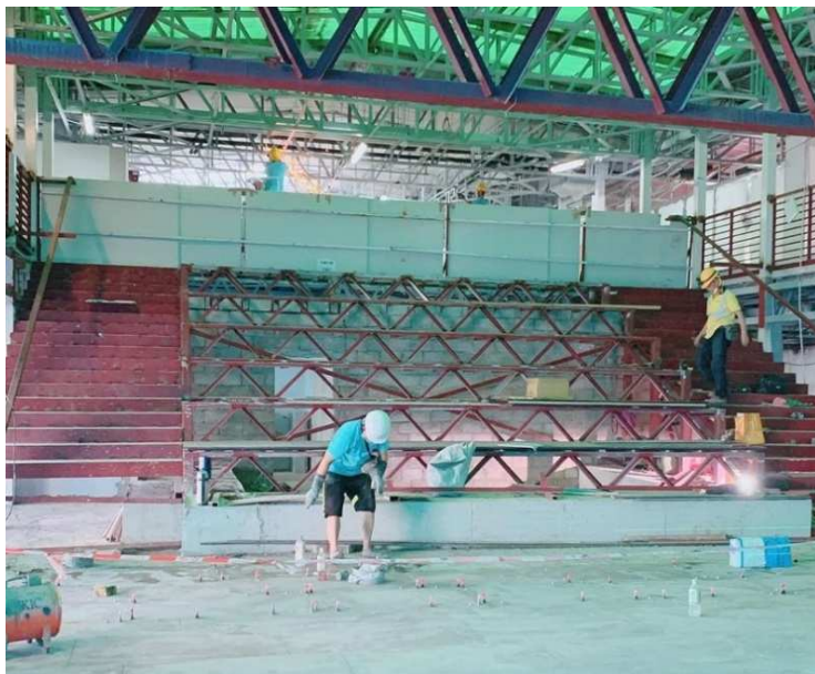
東涌社區聯絡中心 多用途活動空間改建工程 Atrium at CLC under renovation
