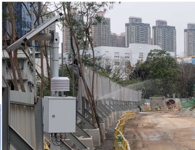
自動定時灑水系統 Automatic sprinklers with timer
